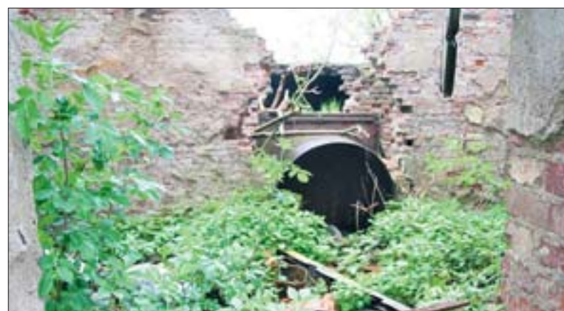
Das verfallene Haus an der B 65 zwischen Kobbensen und Beckedorf war einst Ausgangspunkt der Frischluftzufuhr für den Beckedorfer Stollen.
